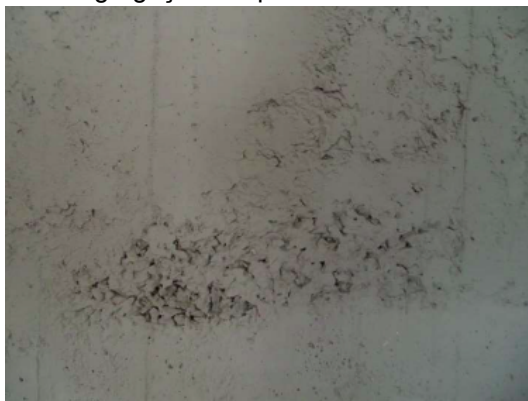
Figura 3: Segregação em parede de concreto armado.
