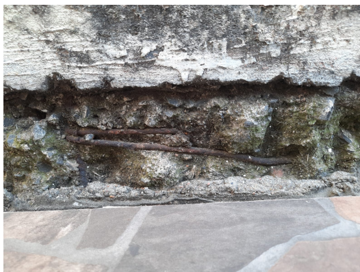
Figura 11: Corrosão de armadura localizada no lado externo da parede.
