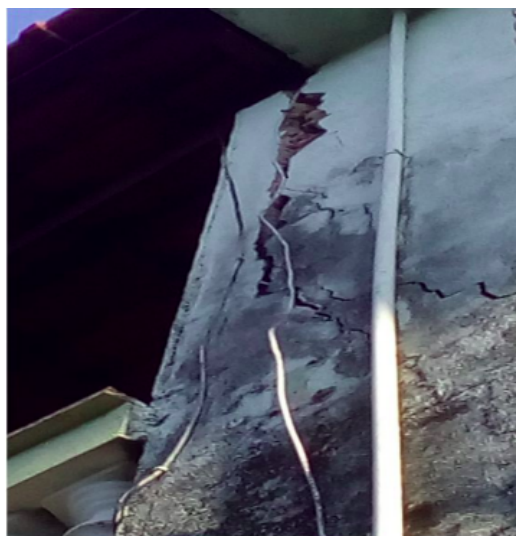
Figura 5: Fendas e umidade identificadas na lateral de uma residência em Campo Belo, MG.
