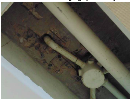
Figura 6: Corrosão de armadura e desagregação em laje de concreto armado.
