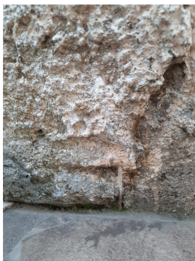
Figura 10: Concreto segregado localizado no muro, próximo ao piso.
