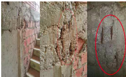
Figura 7: Pilar com corrosão de concreto ocasionado por má execução em um edifício residencial em Teresina, PI.
