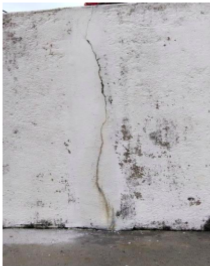
Figura 4: Fissura em um reservatório em Criciúma, SC.
