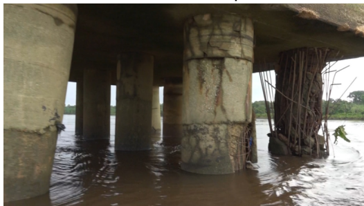
Figura 1: Estrutura deteriorada da ponte sobre o rio Moju.
