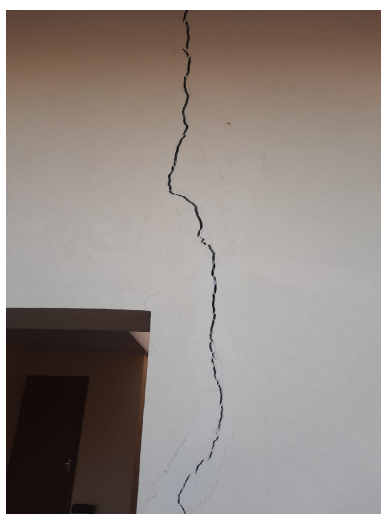
Figura 9: Trinca encontrada próximo à entrada da garagem.
