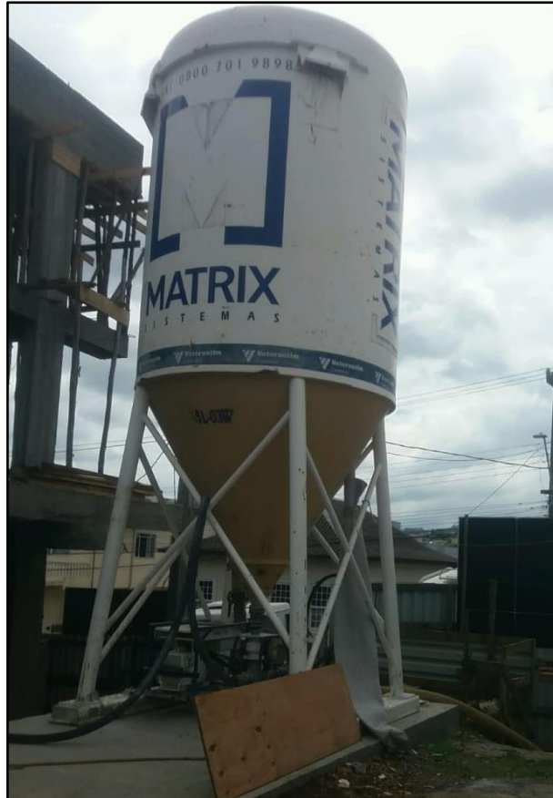
Figura 15: Silo de argamassa para assentamento e reboco
