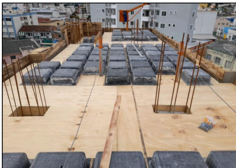
Figura 32: Laje sem guarda-corpo e protetores de vergalhões
