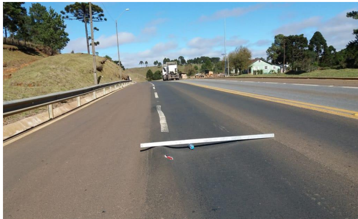
Figura 10 – Afundamento plástico ocorrido no trecho entre Correia Pinto e Lages.
