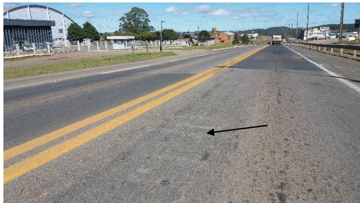
Figura 8 – Trinca no trecho entre Lages a Correia Pinto.
