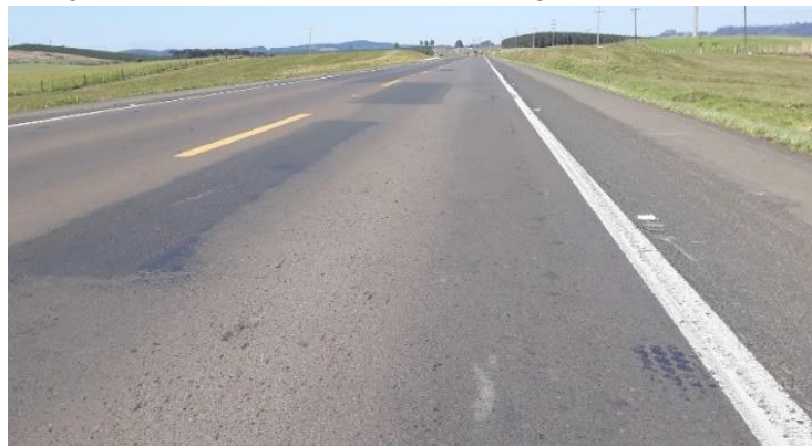
Figura 6 – Fissuras no trecho entre Lages a Correia Pinto.
