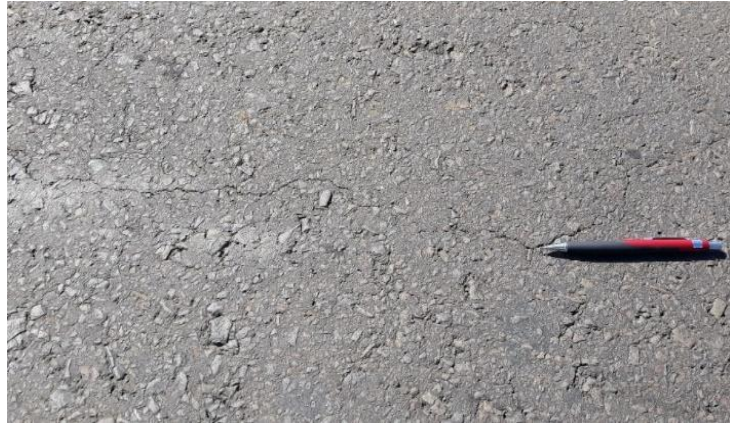
Figura 5 – Fissuras encontradas no trecho da BR-116 entre Lages e Correia Pinto.
