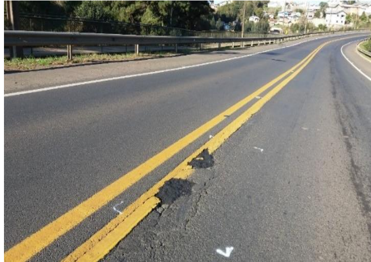
Figura 11 – Buraco devido a fadiga do pavimento na BR – 116 no trecho Correia Pinto – Lages.
