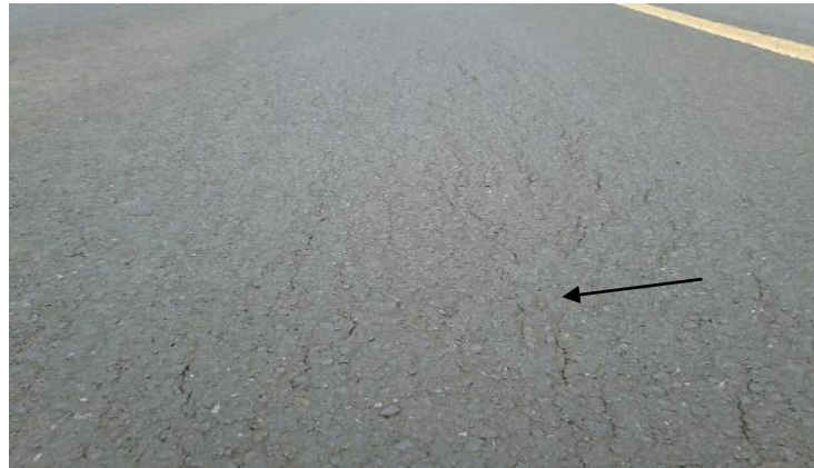
Figura 7 – Trinca localizada na BR – 116, trecho entre Lages e Correia Pinto.
