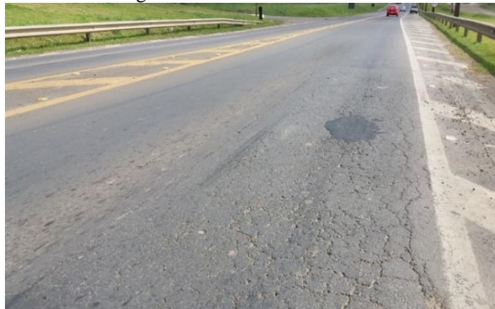
Figura 9 – Trincas na BR – 116.
