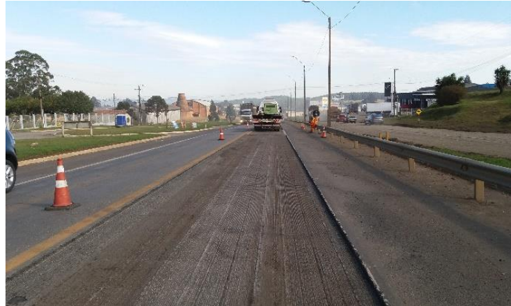
Figura 17 – Trecho estudado da BR – 116 fresado onde havia desgaste no pavimento.
