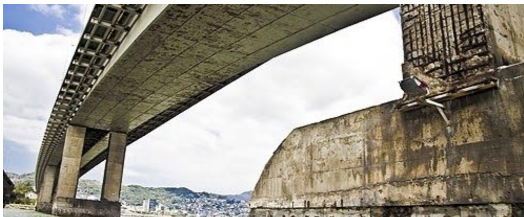
Figura 17: Estrutura danificada na ponte Pedro Ivo Campos.
